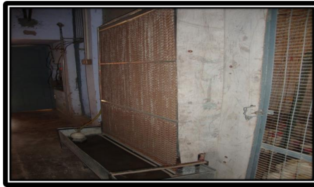
Fan Pad System
